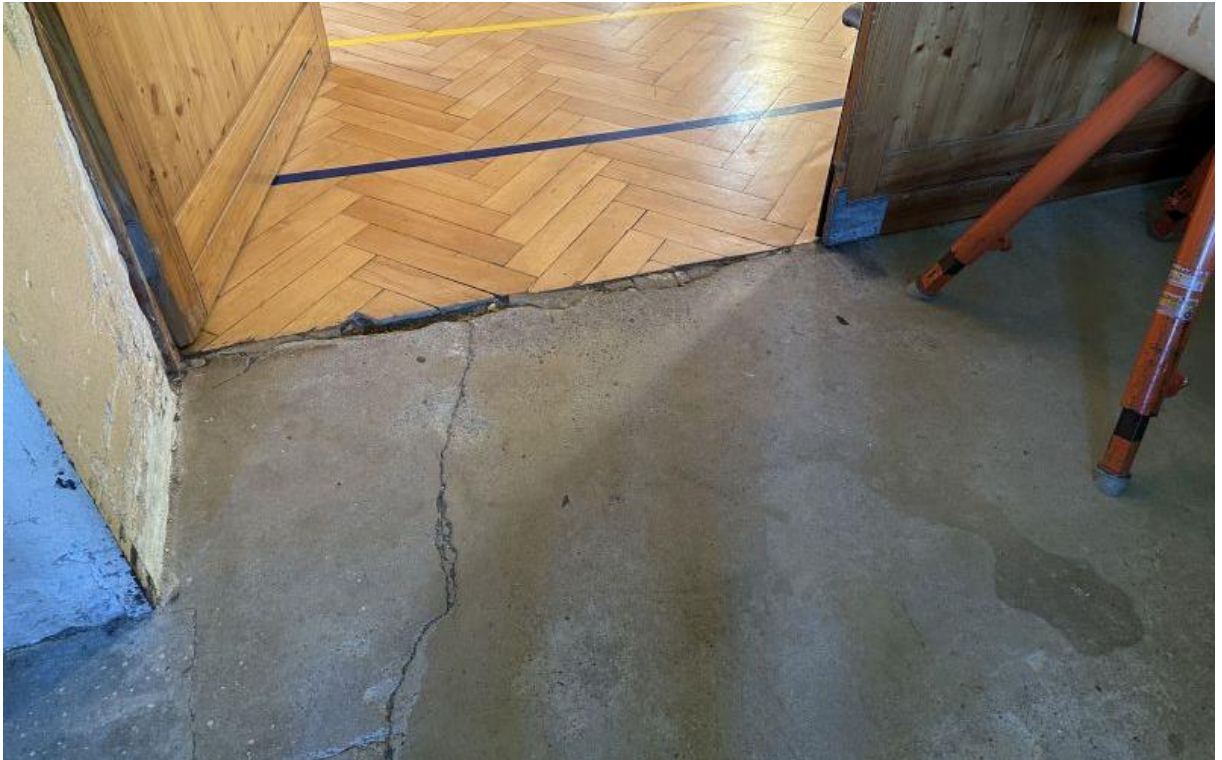
Bild 21: vorhandener Betonfußboden im Bereich des Sportgeräteraumes
