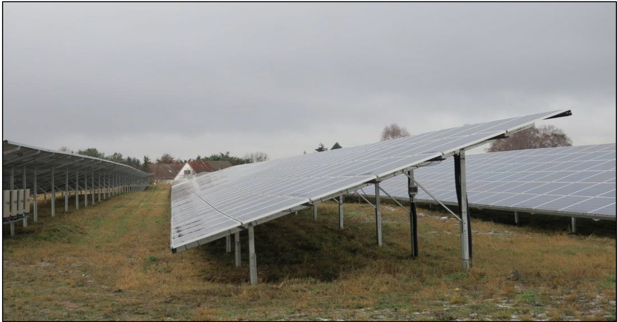
Abb. 2 Beispiel einer vergleichbaren PV-FFA (Südausrichtung)
